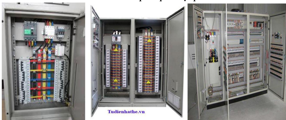
Hình 4.1. Tủ phân phối hạ áp
