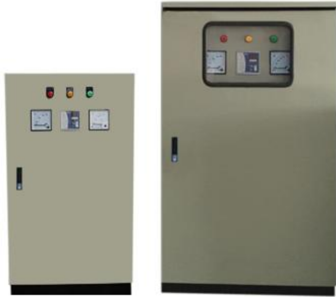
Ảnh minh họa: Tủ tụ bù công suất phản kháng, tủ bù cos phi
